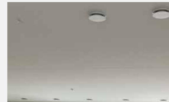
(Toevoer) Ventilatieventielen in het plafond.
