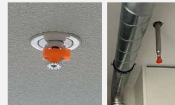
Links: De sprinkler is nog voorzien van een (oranje) bescherming. Deze wordt voor de oplevering verwijderd.
