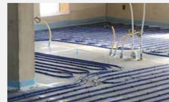
Je vloer ligt vol met het leidingwerk van o.a. de verwarming. Boor of bevestig dus nooit iets in de vloer. De kans is heel groot dat je een leiding raakt.
